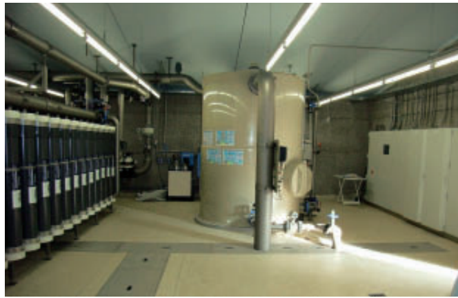
Abb. 4: Ansicht der Ultrafiltrationsanlage mit Schlammwasserpufferbehälter und Schaltschränken
