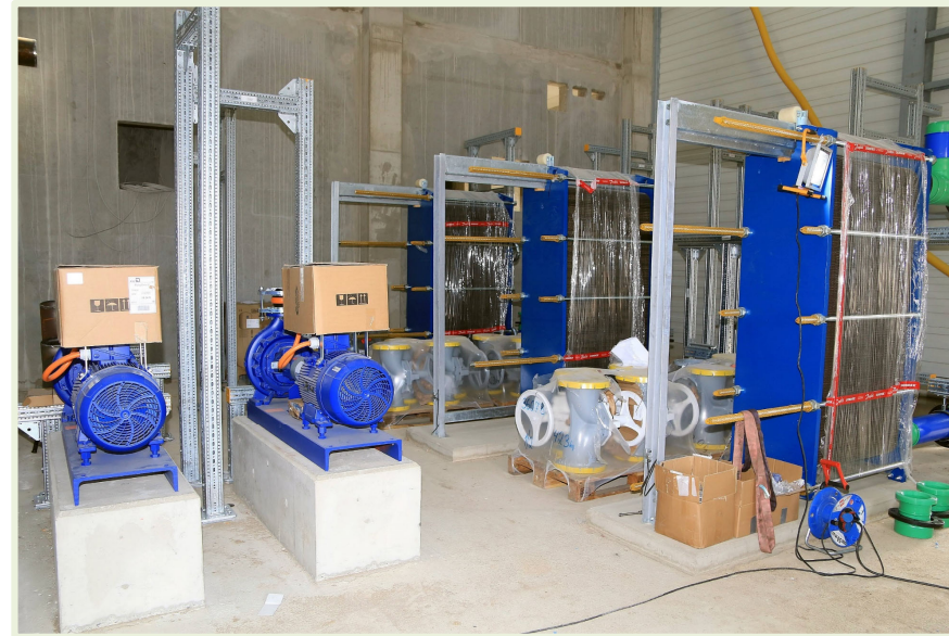
Wärmeübertrager Geothermie Schwerin Lankow
