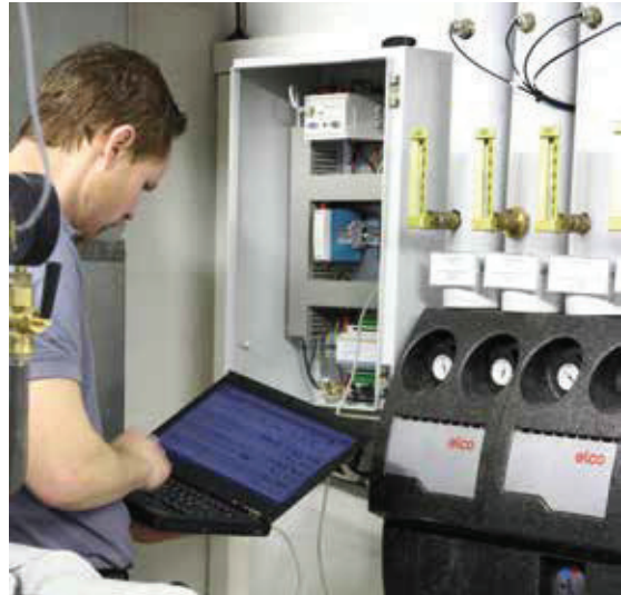
Softwaregestützte Inbetriebnahme und Parametrierung der hochautomatisierten Heizung © Energiezentrale Nord GmbH
