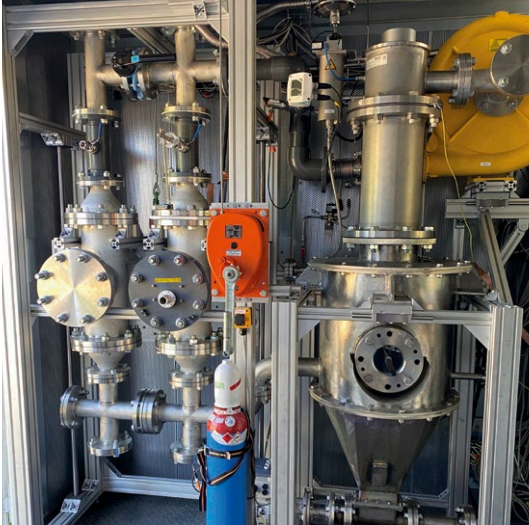
Detailaufnahme der Plasmalyseanlage
