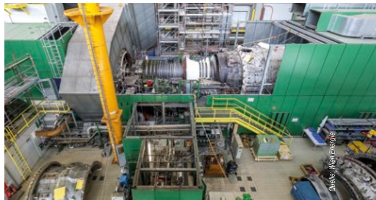
Die Gasturbine im Kraftwerk Donaustadt wird für den Einsatz von Wasserstoff vorbereitet.
