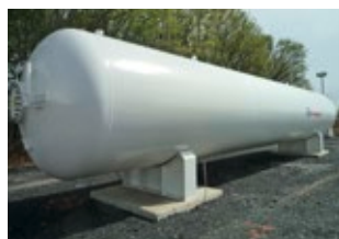
Wasserstofftank auf dem Grundstück in Holzwickede
