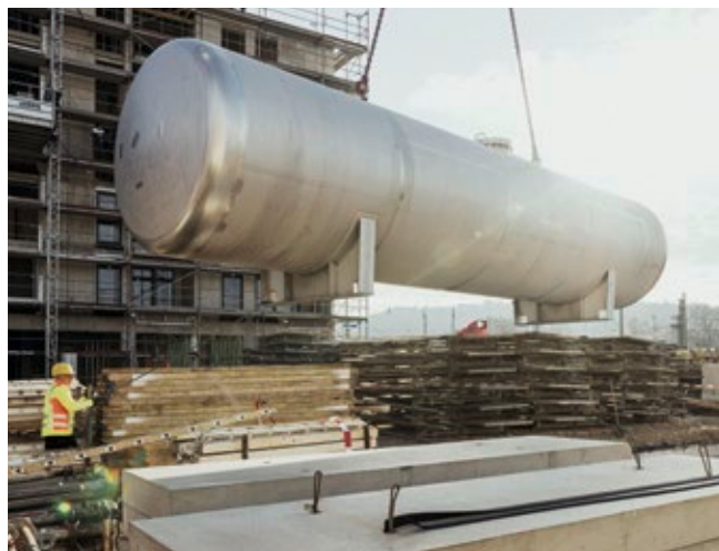
Der H 2 -Speicher ist ein wesentlicher Bestandteil der Energiezentrale.
