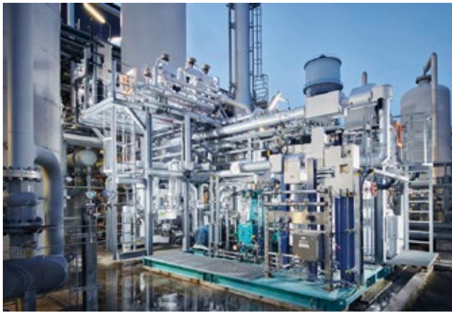
Einblick in die Demonstrationsanlage im nordrhein-westfälischen Dormagen
