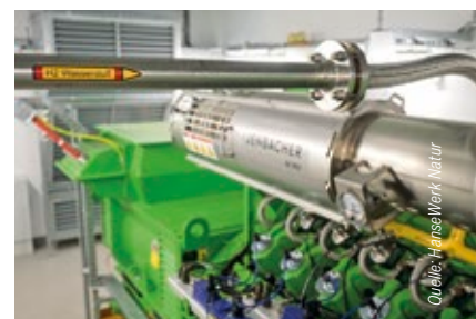
Der Jenbacher Gasmotor von INNIO wurde für den Feldtest temporär umgerüstet.
